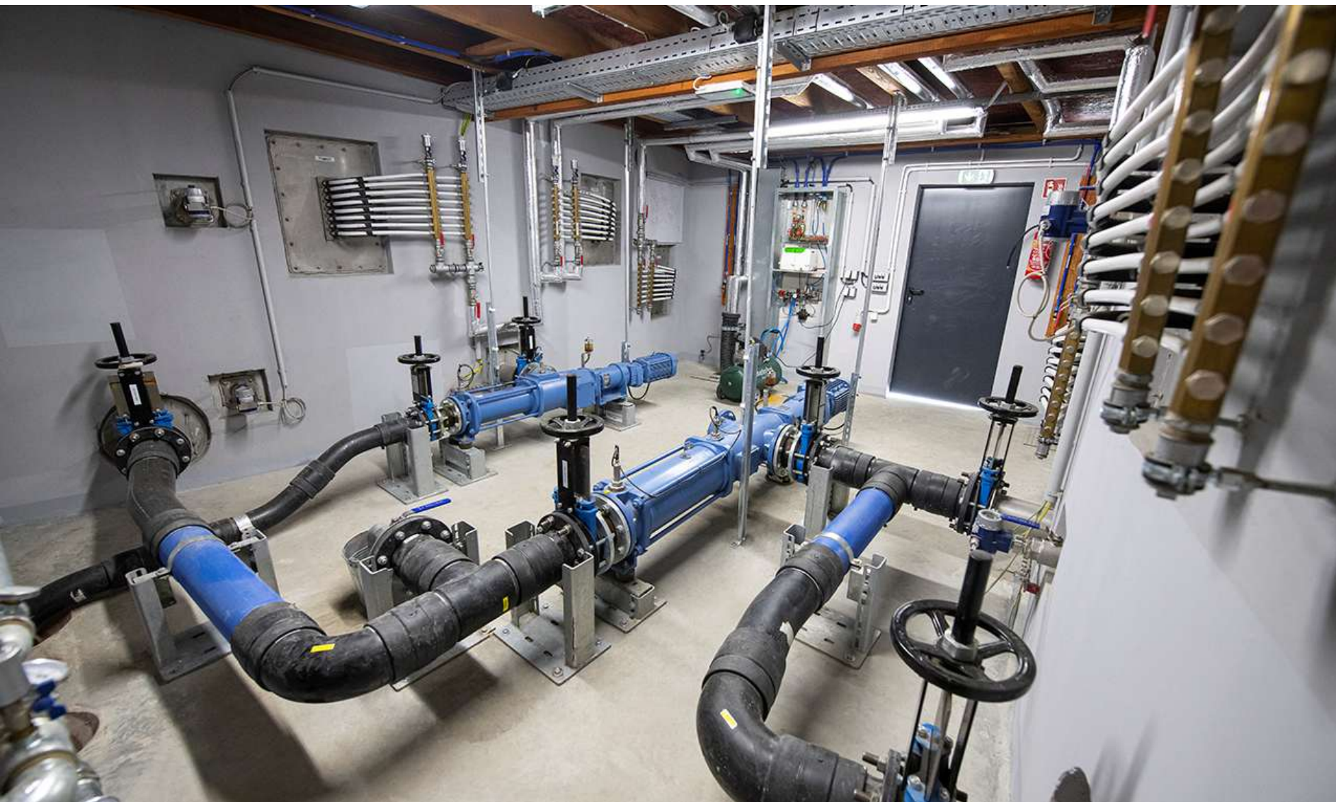
Szacht instalacyjny pomiędzy zbiornikami fermentacyjnymi
